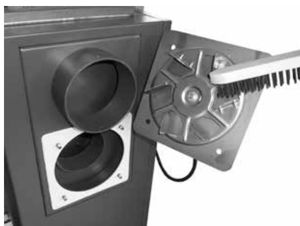
Ukázka čištění oběžného kola a kontrola kolmosti lopatek odťahového ventilátoru
