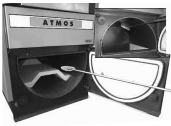
Otevřený spodní prostor kotle se střechou a s ukázkou vyhrabování popela pomocí pohrabáče.
