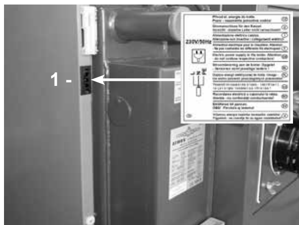
Konektor v pravé kapotě kotle
