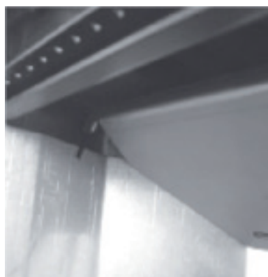
Fig. 15: elevador do defletor de chama
