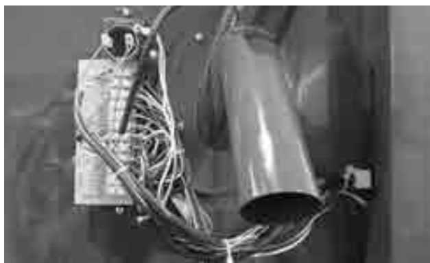
Elektroinstalace kotle pod přední kapotou
