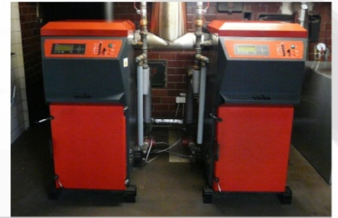
Hotel Tanečnice Pustevny Kaskáda automatických kotlů VERNER
