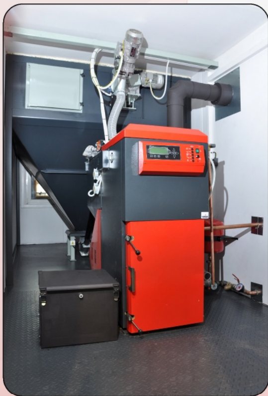
Nahoře: pohled do mobilní kotelny.
