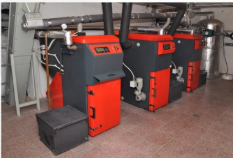
Pension Bejčkův Mlýn Kaskáda automatických kotlů VERNER
